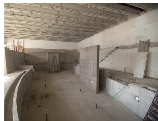
Das alte Becken im Innenbereich diente als Außenschalung. Daran wurde ein rechteckiger Beckenkörper angeflanscht, um die Wasserfläche zu vergrößern.
